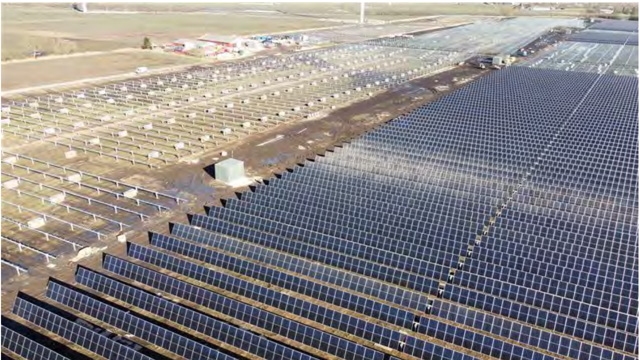
Foto: Eksempel på anlæg af solcellepark med invertere, teknikhuse og transformerstationer.
