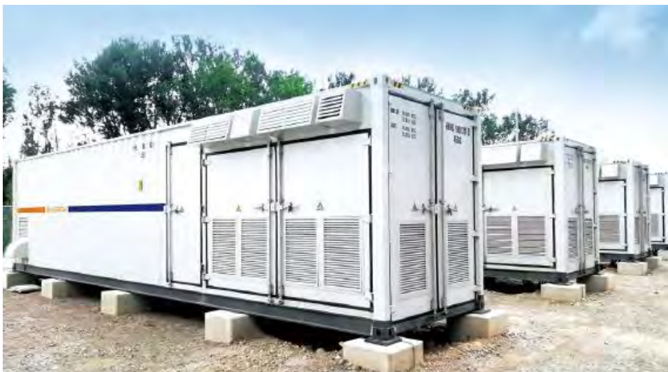
Foto: Eksempel på container med batterier.
